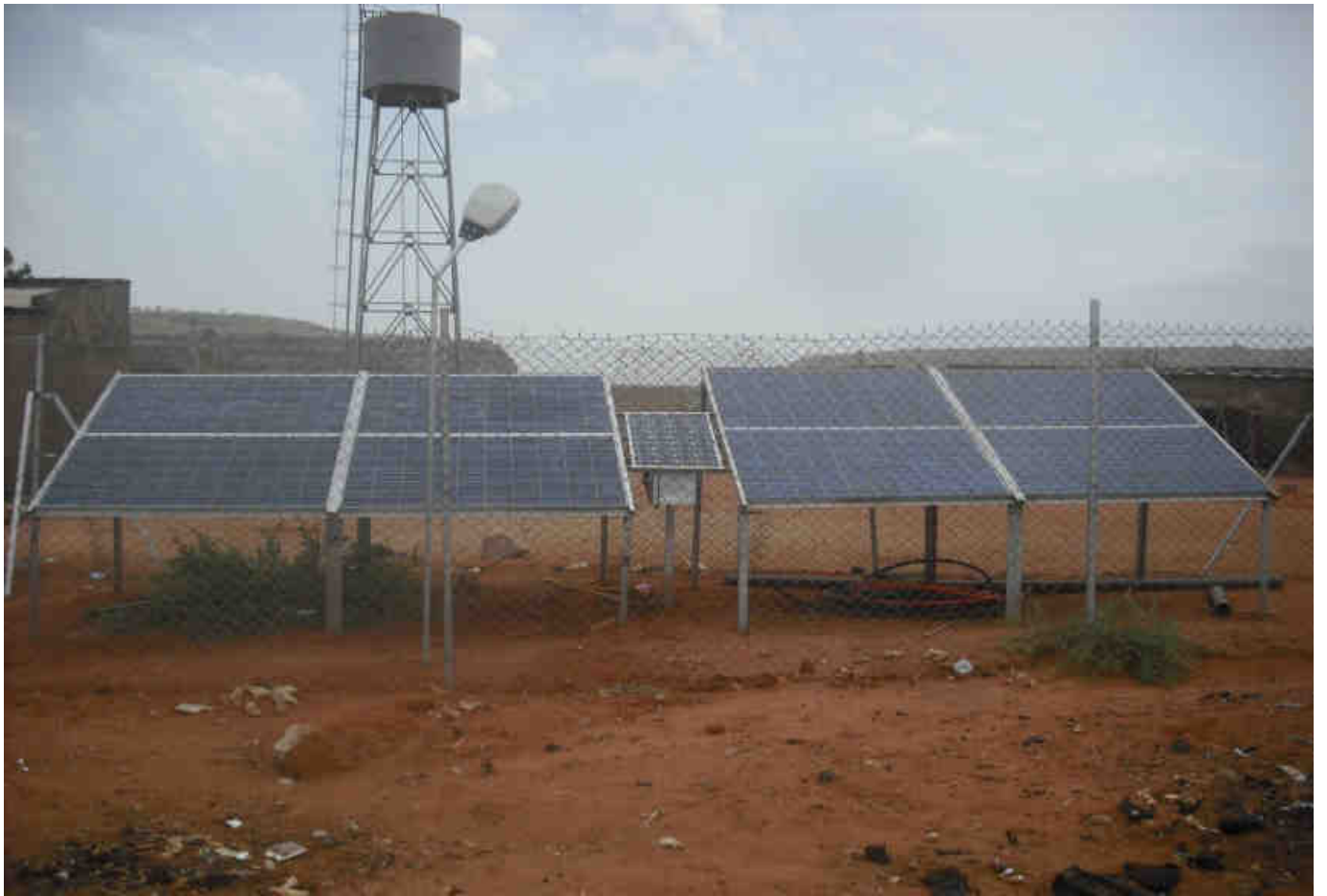
Figure 5 : Château d'eau et champ solaire
