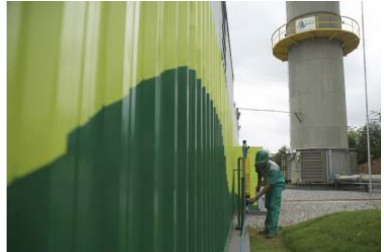
Landfill Gas Collection
