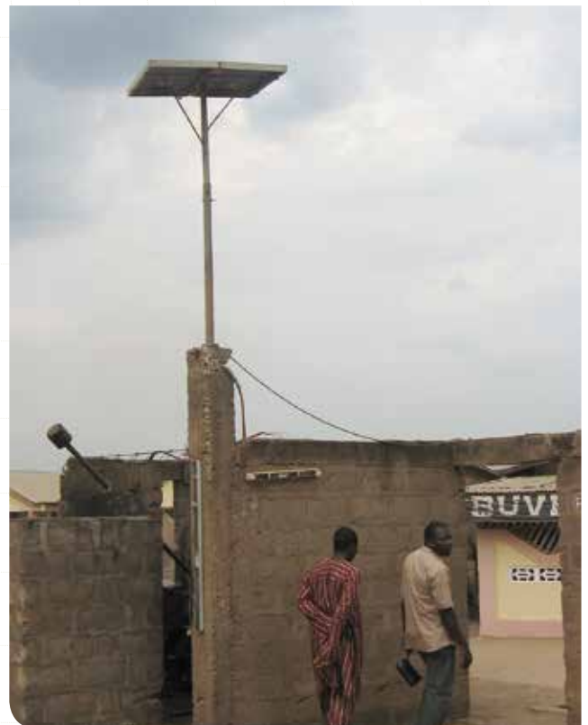
Panneau solaire et station de recharge de téléphone portable au Bénin.
