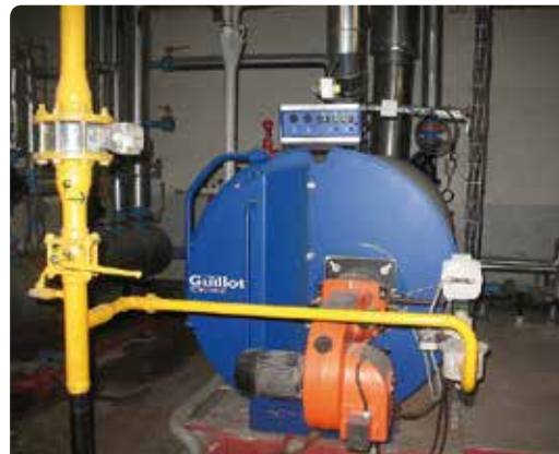
Installation technique visitée par les économes de flux.
