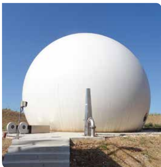
Gazomètre de la station d'épuration d'Hyères
