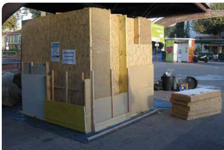
L'atelier propose aux participants de poser correctement les isolants en fibre de bois sur la maquette pédagogique.
