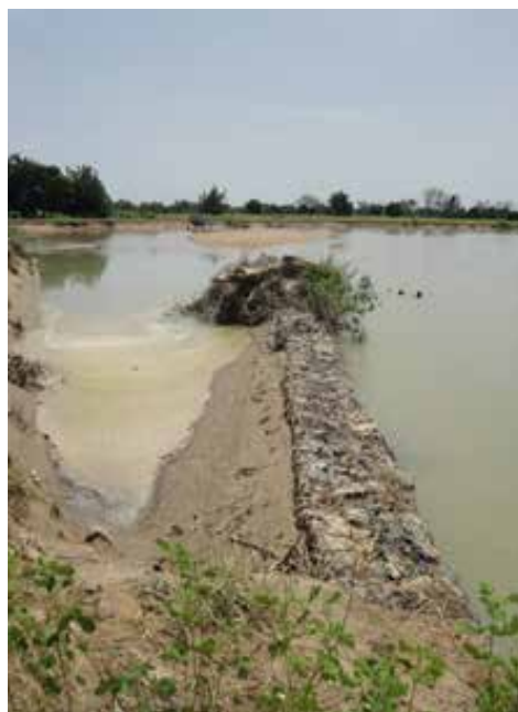
Photo 1 : les menaces d'érosion dans le cours du Mayo Tsanaga ont obligé l'administration à dévier le lit pour sauver les villages environnants et construire une digue pour protéger le pont. Cette digue est aujourd'hui attaquée par l'érosion.
